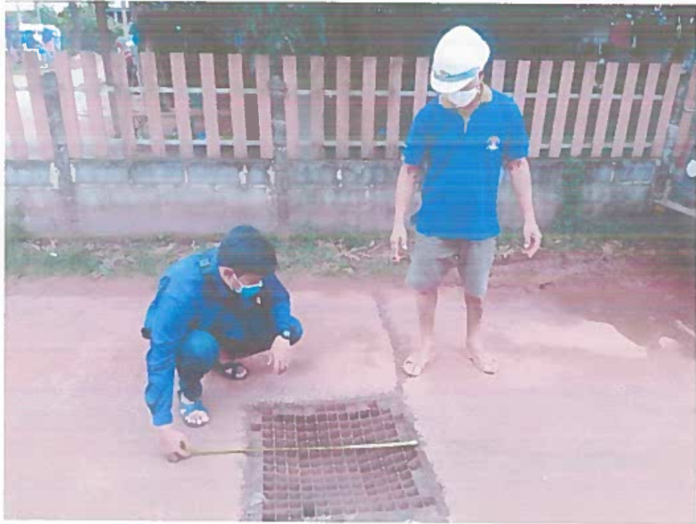
ภาพถ่ายผัดตะแกรงเหล็กที่ชำรุด
